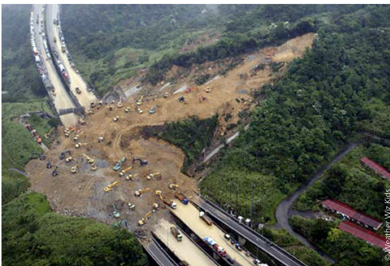
Ilustración 4: Deslizamiento espontáneo profundo.
